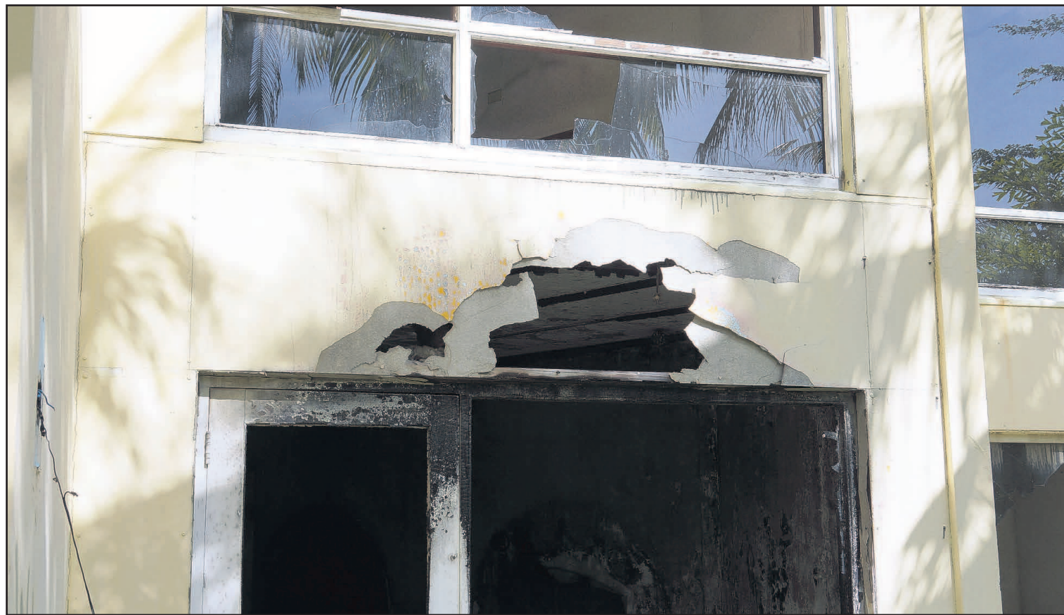
Het voormalige Bushiri-hotel bevat niet alleen asbest in het verweerde dak, maar ook in de muren. Stukken daarvan liggen bovendien op de grond.
