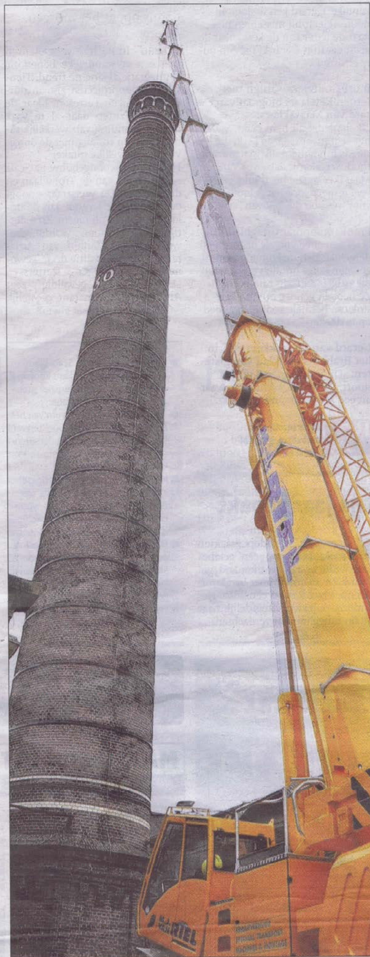
Een grote hijskraan brengt het bakje met de asbestsaneerder naar 45 meter hoogte en laat dat dan in de schoorsteen zakken.
